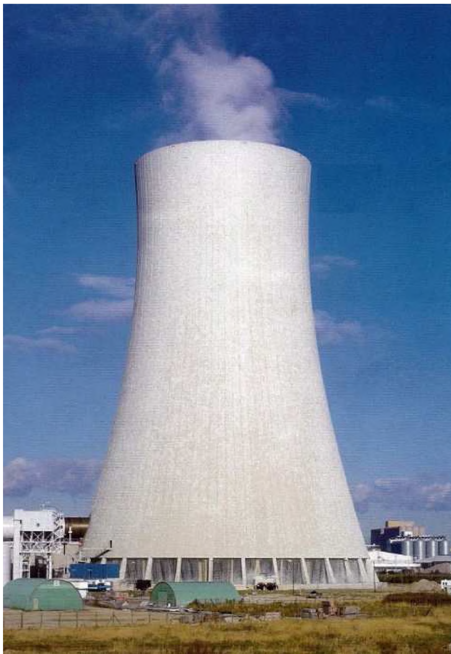
Рисунок 2.9 — Башенная градирня с естественной вентиляцией и противоточным движением потоков воды и воздуха ([9])
