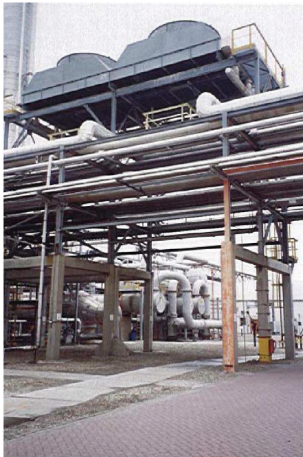
Рисунок 2.23 — Пример применения АВО в химическом производстве
